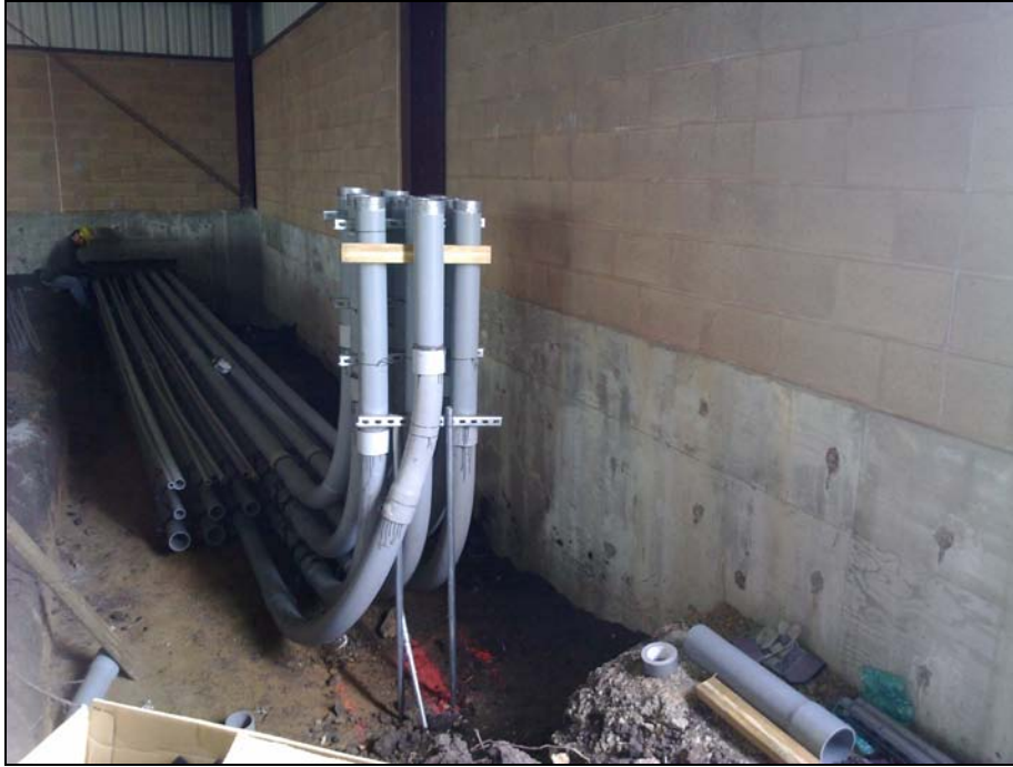
Main Electrical Conduits
